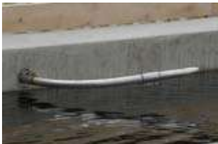
Punto di distribuzione In uscite dal cemento
